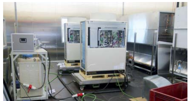
Noch im Aufbau. Bis Ende Juli soll die Prüfstation fertig sein.
